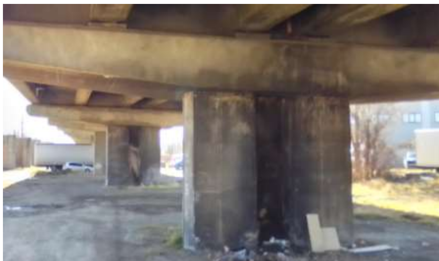
Фигура 2: Подмостово пространство при надлез по бул. „Адам Мицкевич“ при Бакърена фабрика
