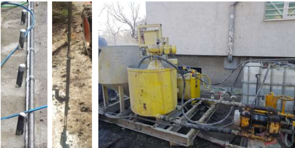
Сн. 1 и 2. Примери за компрометирани сгради – инжекционни тръби; пакер; система за инжектиране.
